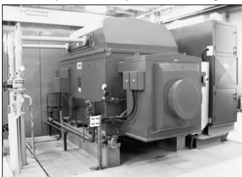
L'alternateur, production de courant électrique 70 Mio KWh
