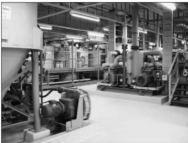
La station d'épuration des eaux utilisées pour le nettoyage des fumées de la saidef
